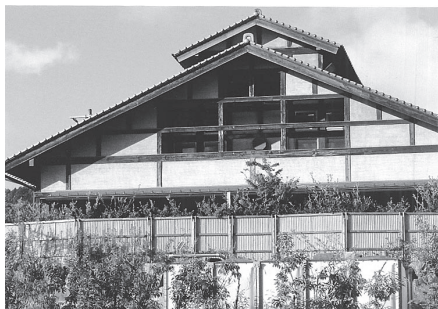
長者の湯浴室棟 剥がされた天井側壁
